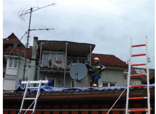
Großes Loch im Hausdach/ Güttingen
