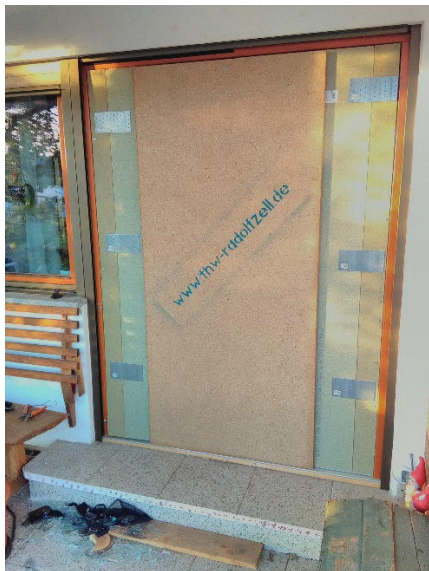
Kaputte Terrassen- türe, folge von einem Einbruch Böhringen
